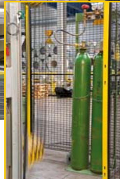
Réserve de bouteilles de gaz avec du gaz Argon inerte
