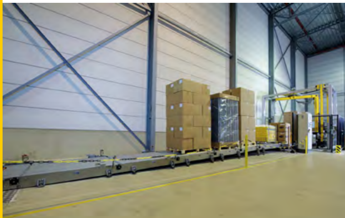
Le convoyeur long, sous une faible pente, assure un grand espace de tampon.
