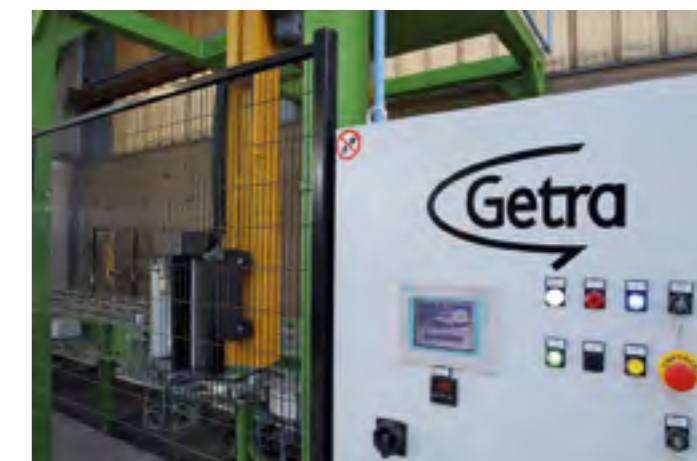
L'armoire électrique avec PLC de Siemens.
